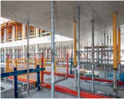
Les rails RCS de la plateforme d'extension RCS MP sont insérés entre deux dalles d'étages, à l'aide d'étais MULTIPROP.
