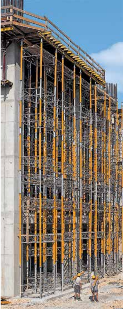
Tours MULTIPROP pour l'étalement d'une dalle en encorbellement de 20 m de haut.
